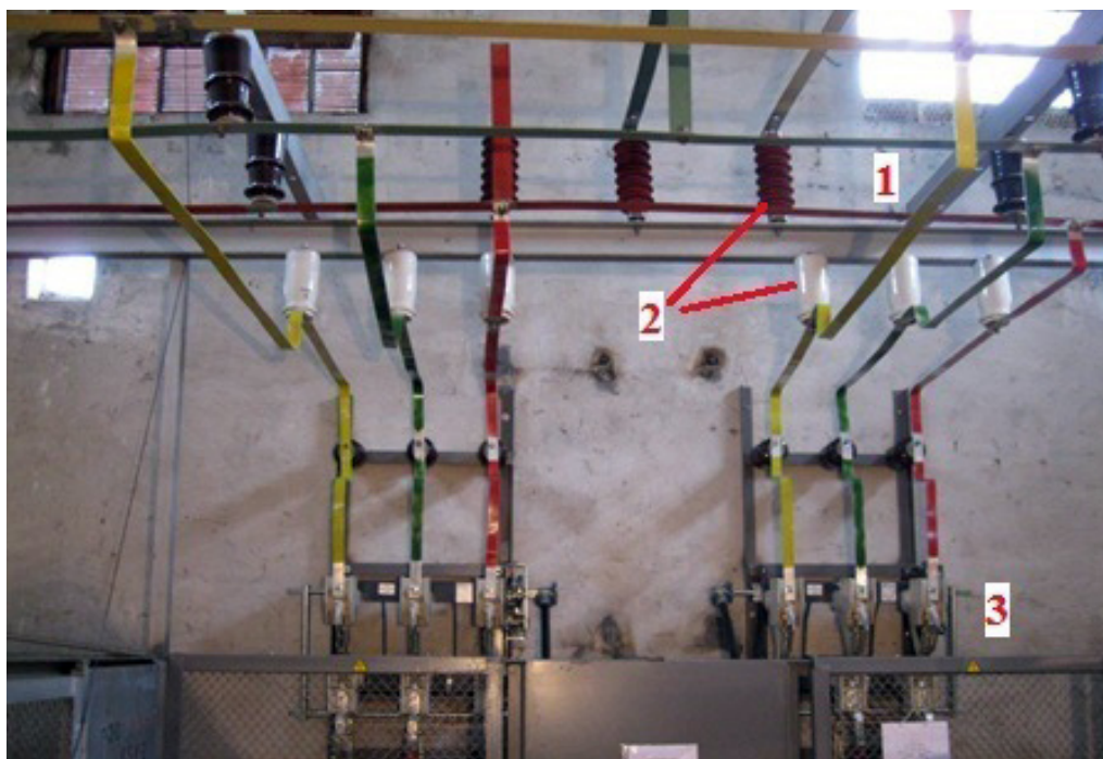
5.3. attēls. Vidsprieguma kopnes un iebūvētā apakšstacijā. Savienojošās kopnes (1), izolatori (2), augstsprieguma drošinātāji (3)
