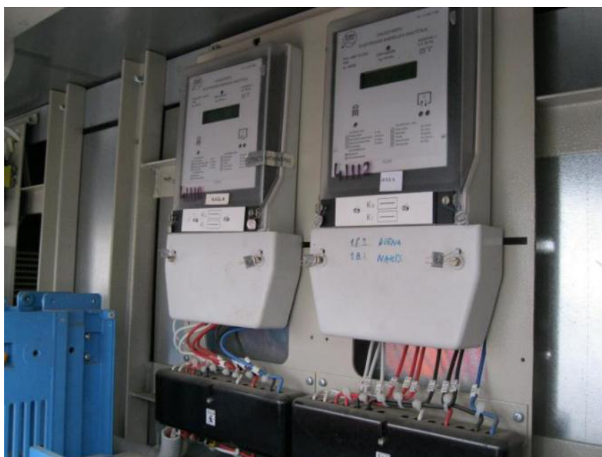
6.8. attēls. Elektroenerģijas uzskaitē KTA ar daudzfunkcionālajiem elektroniskajiem skaitītājiem
