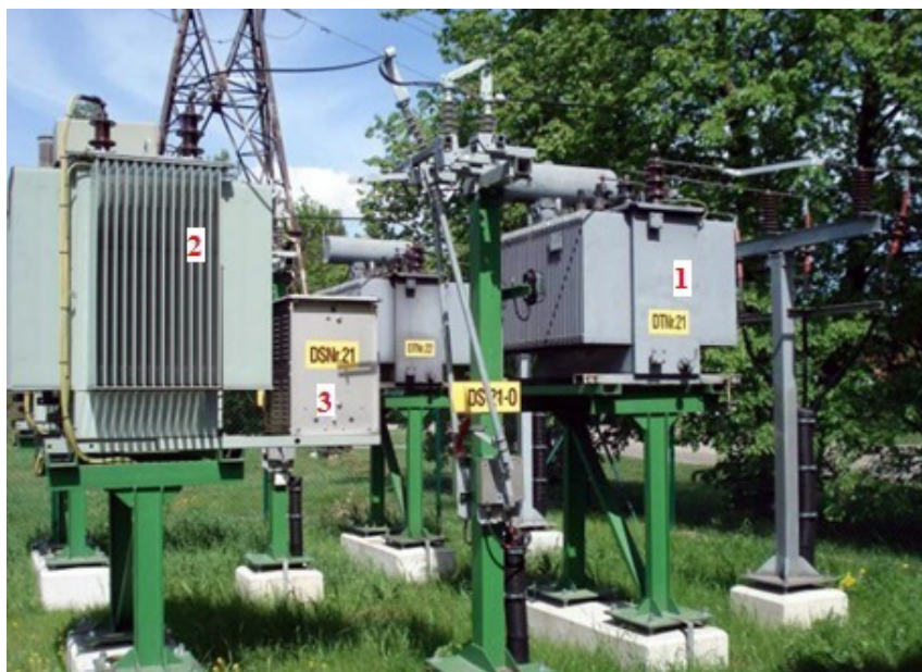
4.4. attēls. Neitrāles transformators (1), zemesslējuma strāvu kompensējošais lokdzēses zemētājreaktors (2), zemētājreaktora automātika (3)
