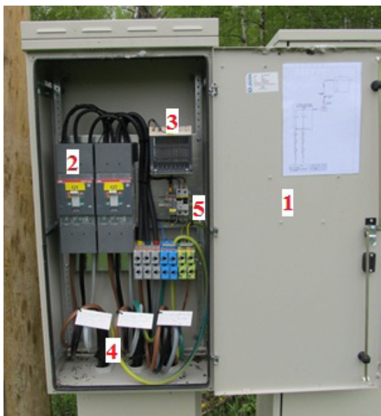
5.14.attēls. Pēc ST inženieru ierosinājumiem pilnveidotā 1 kV RAS (relejaizsardzības) sadalne. Vienlīnijas shēma (1), galvenais blokslēdzis (2), mērtransformators releju aizsardzībai (3), kabeļu pievienojumi (4), drošinātājslēdži (5)
