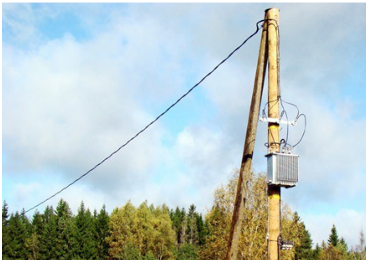
10.4. attēls. 1kV GVL ar piekarkabeli un 1/0.4kV TA balstā
