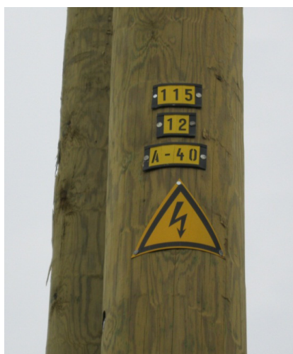
10.14. attēls. Balsta operatīvais apzīmējums. No augšas: balsta numurs, izbūves gads, līnijas numurs
