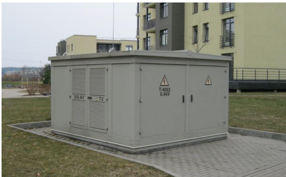
6.5. attēls. Kompaktā 20 (10)/0,4 kV transformatoru apakšstacija (KTA)
