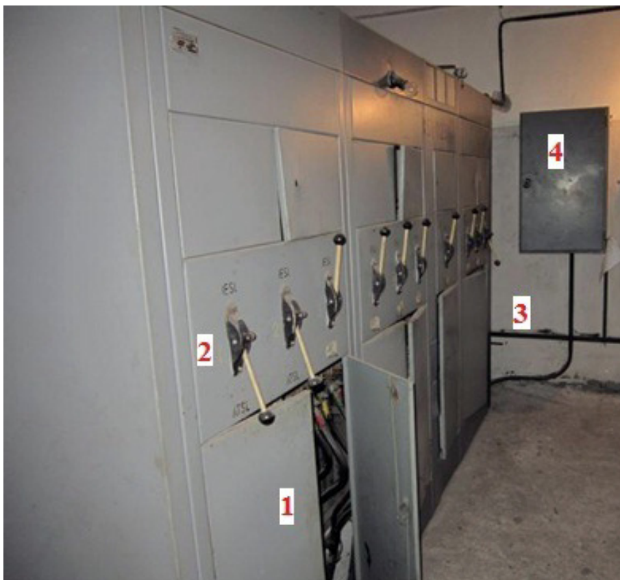
5.2. attēls. Eksploatācijā esošas novecojušas zemsprieguma sadalietais. Kabeļu pievienojumu nodalījums (1), drošinātāju bloku piedziņa (2), apakšstacijas zemējuma kontūra kopne (3), apgaismojuma sadalne (4)
