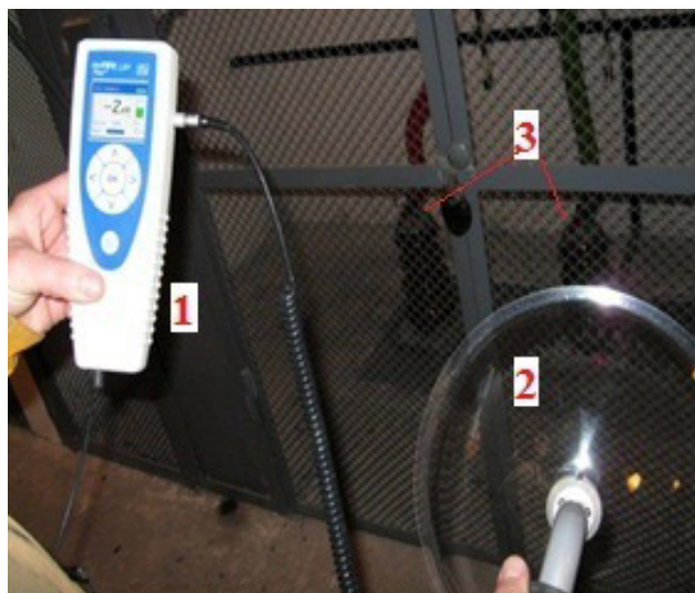
5.10. attēls. Parciālās izlādes diagnostika vīdsprieguma jaunā tipa slēgiekārtā un iebūvētā 20 kV vecā tipa sadalietaisē. Mēraparāts (1), šķīvis akustiskā signāla uztveršanai (2), kopņu pievienojumi caurvadu izolatoriem (3)
