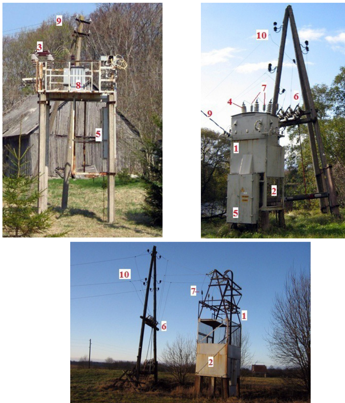
6.2. attēls. Joprojām ekspluatācijā esošas novecojušas konstrukcijas komplektās 20/0,4 kV transformatoru apakšstacijas, kuras nepieciešams rekonstruēt.
