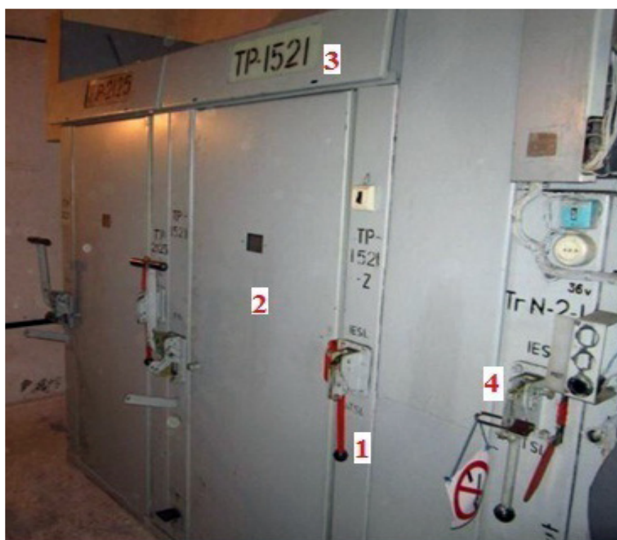
5.1. attēls. Ekspluatācijā esošas vecā tipa sadalietais iebūvētajā apakšstacijā. Svira zemēšanas nažu ieslēgšanai (1), jaudas slēdža nodalījums (2), pievienojuma virziena rādītājs (3), svira piedziņas darbināšanai (4)
