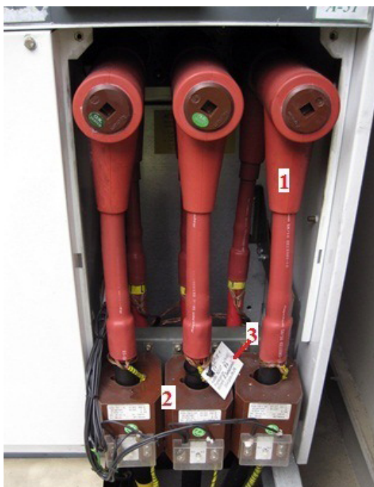
5.9. attēls. Sapārotu kabeļu pievienojums slēgiekārtai ar T-veida spraudņiem (1) un uzstādītiem strāvmācītiem (2), kabeļu montāžas birkām (3)
