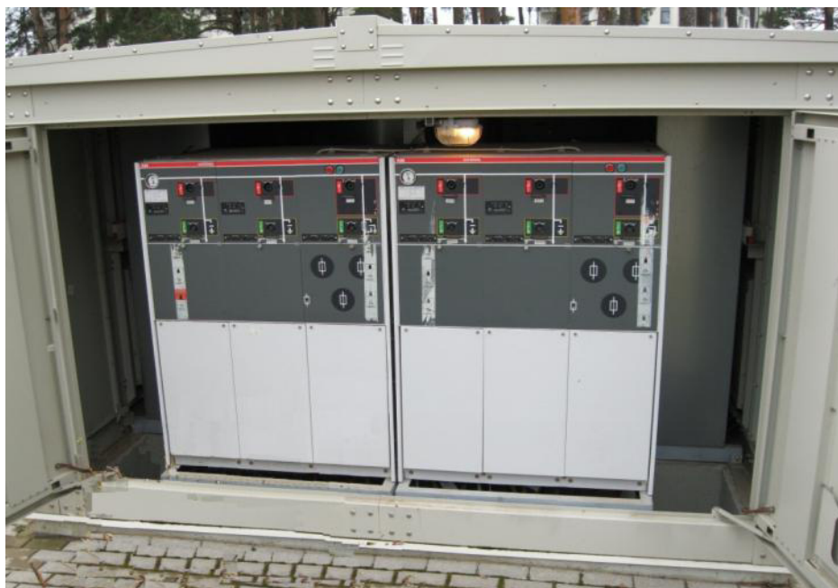
6.6. attēls. 20 kV slēgiekārtas nodalījums KTA, kur uzstādīta tipiska RMU (Ring Main Unit) – vairāk paneļu slēgiekārtā kabeļu un transformatora pievienojumu komutācijai
