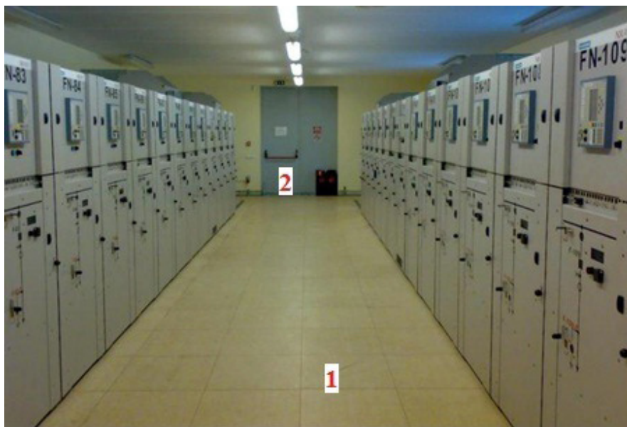
5.5. attēls. Rekonstruēta mūsdienīga vīdsprieguma sadales telpa 110 kV apakšstacijā ar uzstādītām primārajām slēgiekārtām. Grīda (ar noceļamām plāksnēm) virs kabeļu pagrabstāva (1), durvis ar vienkāršotu atvēršanas mehānismu no iekšpuses (2)
