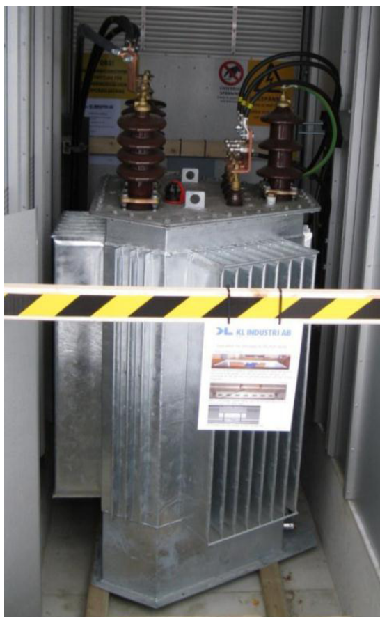
7.7. attēls. Kompensējošais transformators. Tā apakšdaļā iebūvēts kompensējošais tinums
