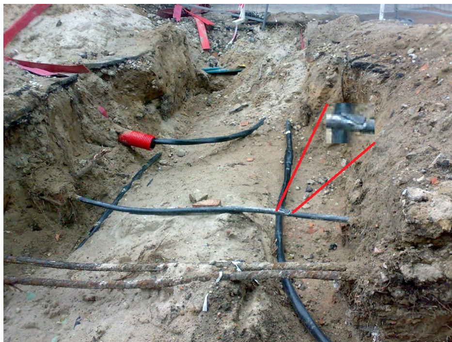
11.6. attēls. Kabeļu izvietošana tranšējās ar esošām (eļļas) kabeļu līnijām priekšplānā, kabeļa aizsarglentu attēla augšpusē un bojātu kabeli palielinājumā
