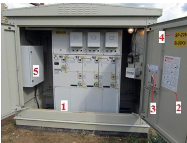
5.8. attēls. Sadales punkts kompaktā metāla korpusā ar slēgiekārtu. Slēgiekārtā (1), instrukcija pirmās medicīniskās palīdzības sniegšanai (2), vienlīnijas shēmas drošā apvalkā (3), operatīvais apzīmējums (4), sadalne (5)
